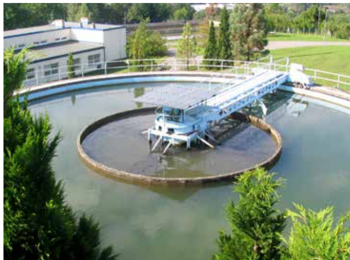
Úpravna vody v Klečůvce. / foto: MOVO
